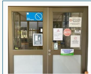
Puertas con acceso eléctrico
